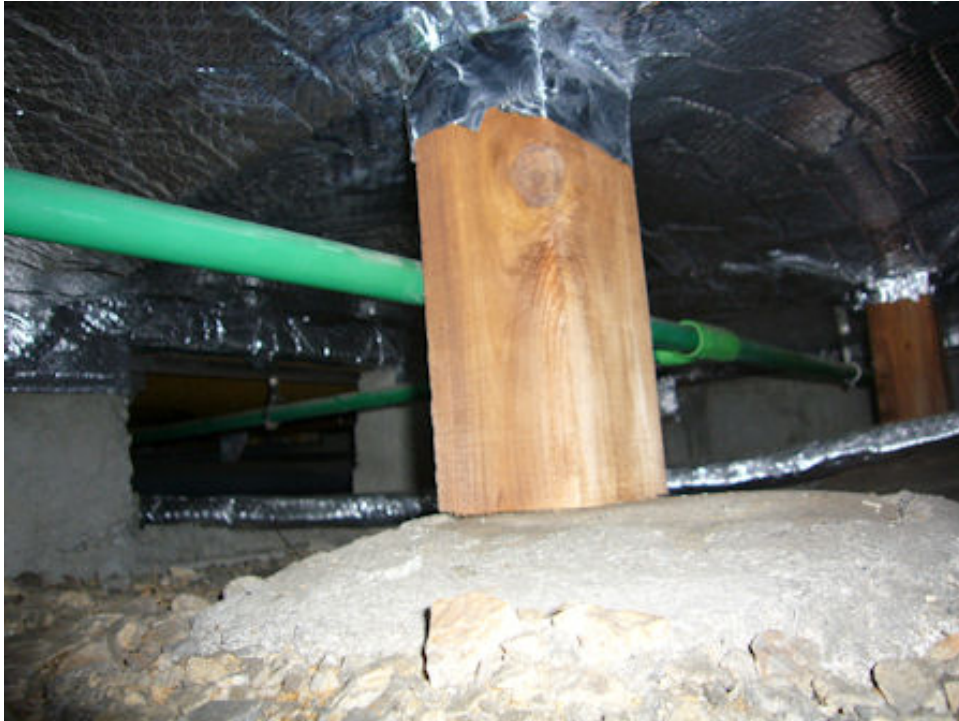
緑の配管はガス管 温水配管にもサモバリアWを巻きました。
